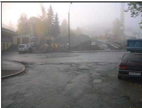
Bilde 48 Brattlikollen, Oslo. Hull og lapping i asfalten i gangarealet inn mot T-banestasjon
