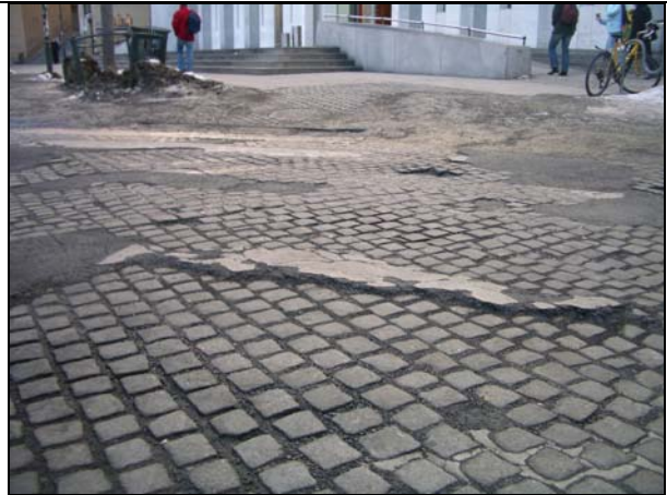
Bilde 49 C. J. Hambros Plass, Oslo. Fotgjengerfeltet er lappet med asfalt, og revet opp igjen.
