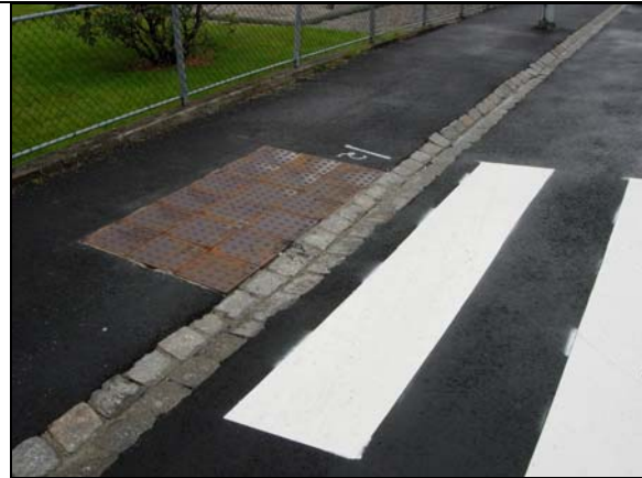
Bilde 3 Bergen. Ett problem er ofte at det er vannrenner, steinsetting, motbakke opp fra nedramping til gangfelt osv som gjør helning og underlag i sum brattere enn den er tenkt. (Her skulle det også ha vært oppmerksomhetsfelt inn til gjerdet).
