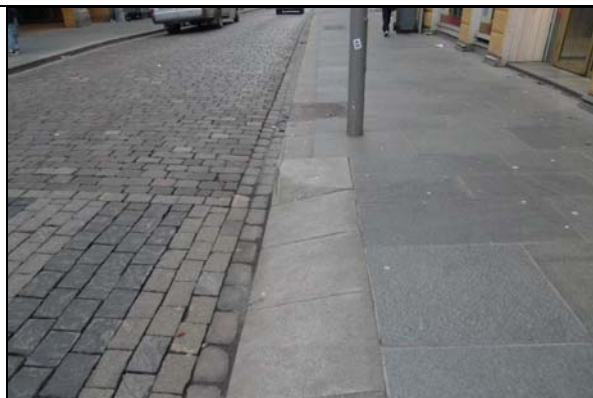
Bilde 9 Bergen – her er nedsenkningen blitt for bratt og steinsetting i overgangen øker virkningen av at det er bratt.
