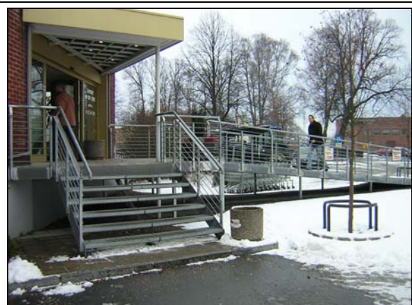
Bilde 115 En dårlig utført trapp. Det er et farlig hulrom, et ujevnt trinn i bunnen og for kort rekkverk.
