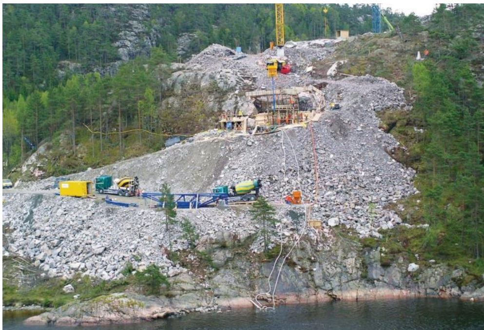
Figur 6-3. Tiltak i anleggsfasen skal omtales, men skal bare inngå i omfangsvurderingen hvis de gir varige virkninger. Bildet viser arbeider i forbindelse med etablering av brupilarer for den nye Svinesundbrua (foto: Statens vegvesen).
