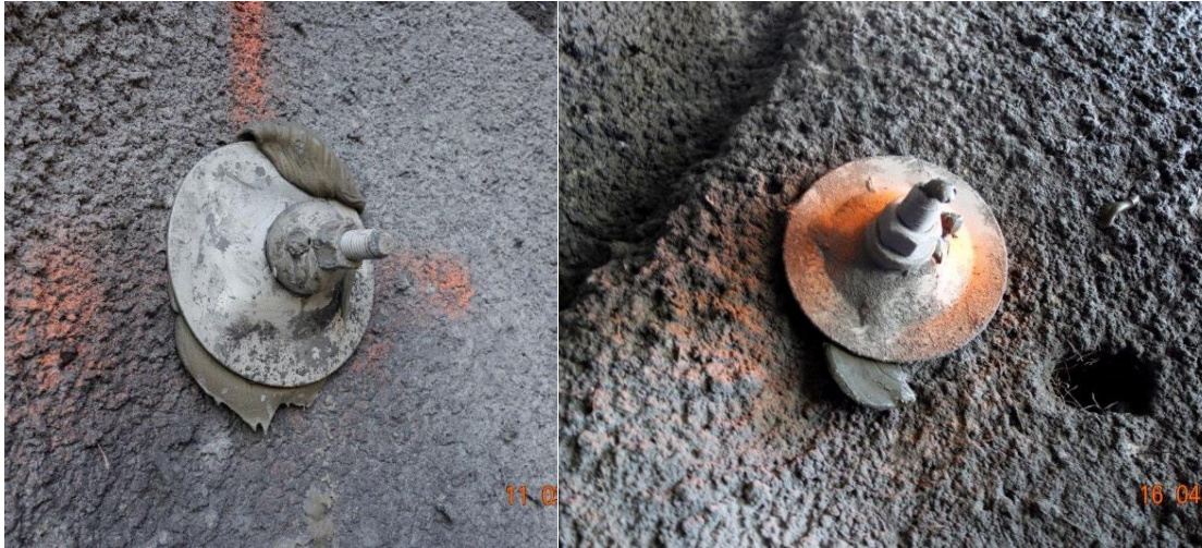
Figur 7.3 Mørtel ut bak plata er en god indikasjon på full oppfylling av bolt og hull (Foto: T. Kirkeby)
