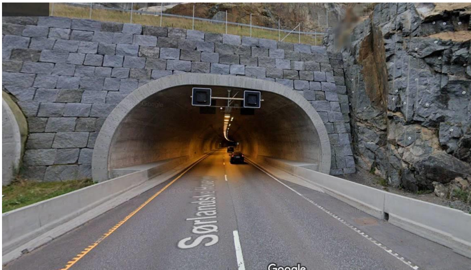
Figur 4.1 Eksempel på rekkverkløsning mot- og inn i portal. Betongrekkverk uten hulrom mellom rekkverk og vegg, som er en god løsning med tanke på drift og vedlikehold (E18 Larvik, Foto: google).
