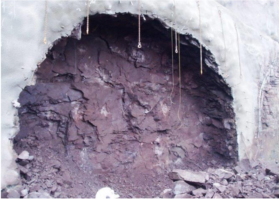
Figur 7.6 Med god forhåndssikring og skånsom sprengning kan påhuggsprofilen stå selv i meget oppsprukket berg. Frodeåstunnelen, Tønsberg. (Foto: T. Kirkeby)
