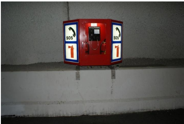
Figur 5.6 Eksempel på nødstasjon plassert på føringskant. Skilt for brannslukkere og telefon er her innfelt som del av nødstasjonen. (Foto: T.Braaten)
