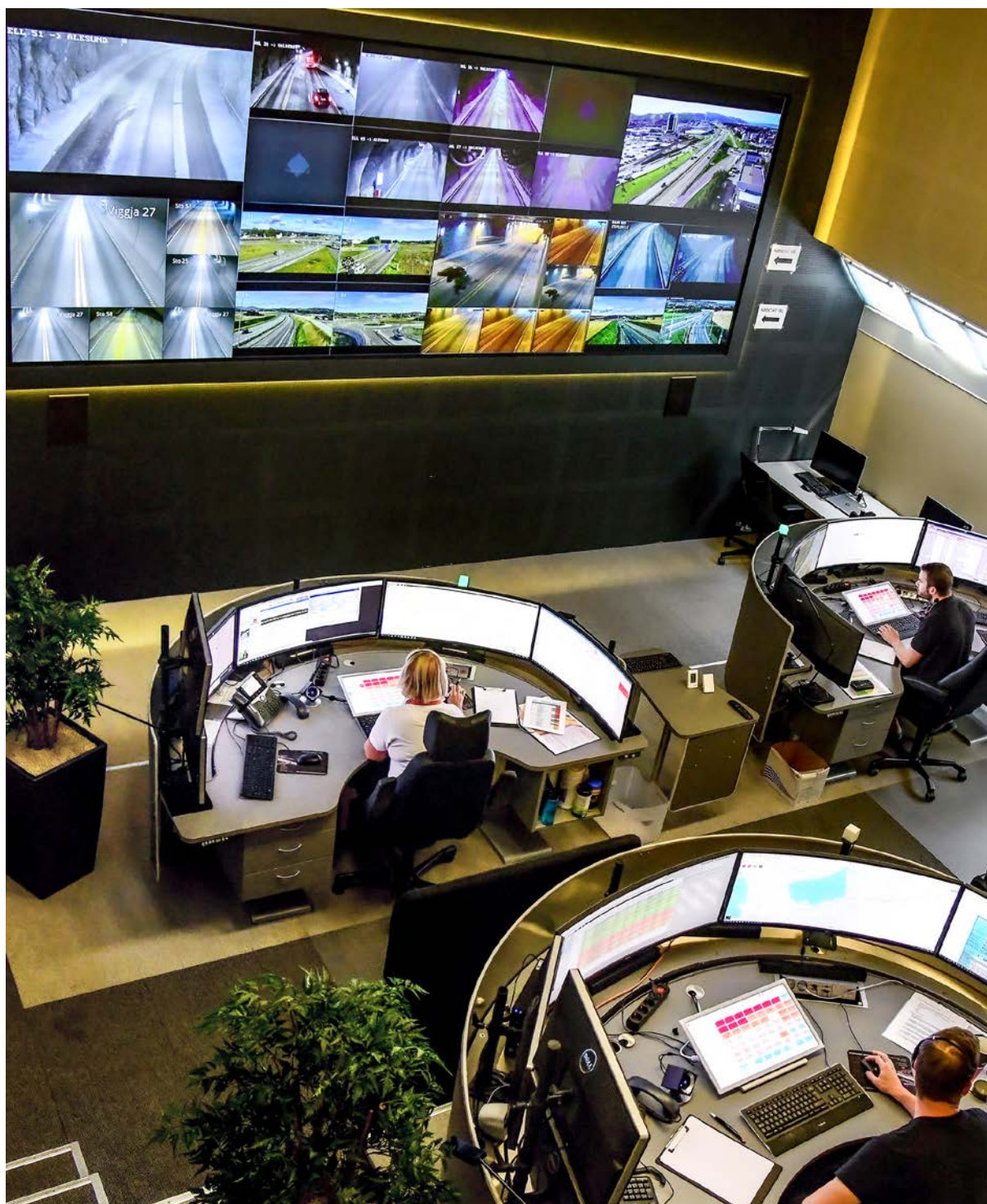
Kontrollrommet ved Vegtrafikksentralen. Foto: Knut Opeide / Statens vegvesen
