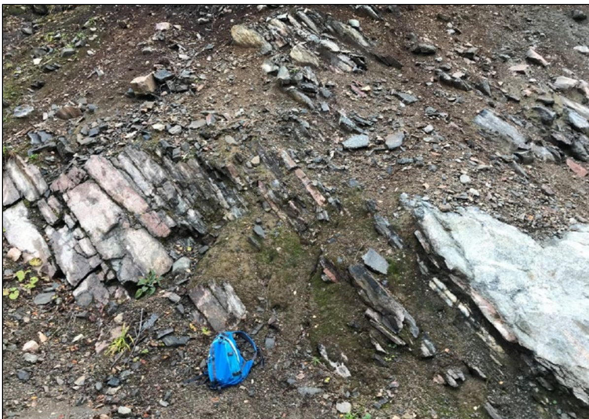
Figur 61 Del av svakhetssone i bergskjæring ovenfor Tomrefjord (sett mot øst). Foto Statens vegvesen.
