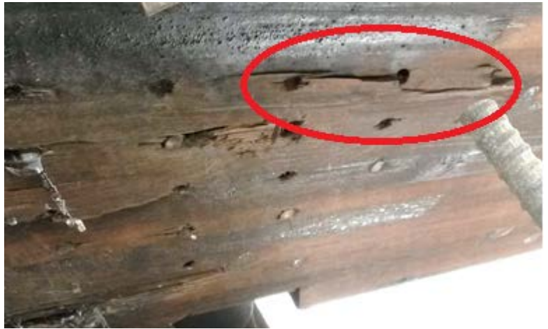
Figur 1 Skader på tre på Sundbyveien. Skadene viser strekkbrudd på tvers av fibrene utover (rød ring). Kraftretning av forbindelsen er ikke i denne retningen og skaden tilordnes montasjefasen. Skadet trevirke bør trolig meisles bort.
