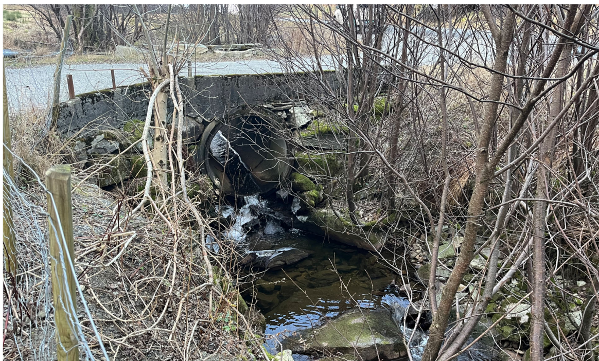
Figur 6. Rør under lokalveg like nord for den lukkede strekningen ved Oppheim.
