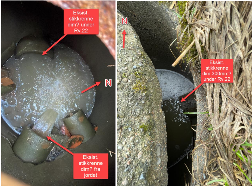
Figur 13. Bilde fra befaring - punkt K5 (venstre) og K6 (høyre). Innløp og utløp kulvert ved Åstorp (felt 3).
