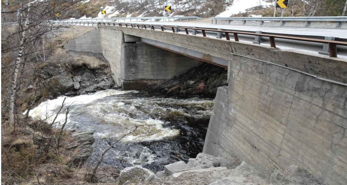
Figur 28: Viser synlige spor av erosjon langs elvebredd nedstrøms eksisterende Tunnfoss bru. Foto: Sweco AS
