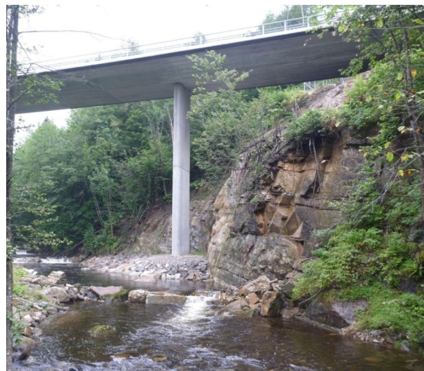
Figur 9: Oppsprukket og løst fjell på sydsiden av dagens E16 bru over Isielva ved Bjørum sag.
