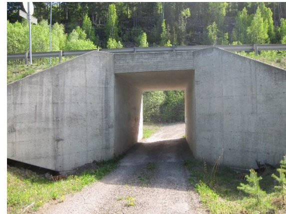
Undergang ved rasteplassen
