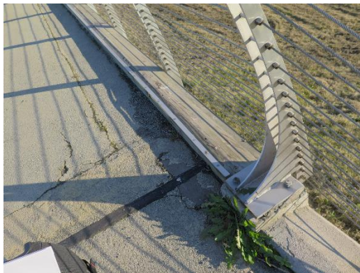
Foto 17. Asfaltdekke på brubanen, søndre side av vestenden. Asfalten er sprukket opp flere steder.
