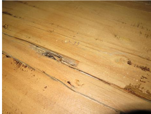
Foto 5. Sørbue, østre del, ca 8 m fra fundament. Ingen tegn til videreutvikling i råtesopp-skaden som ble konstatert i 2007.
