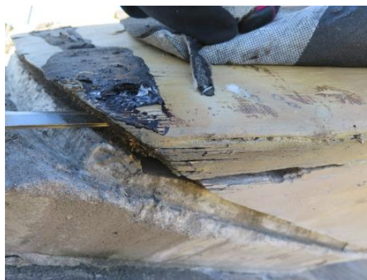
Foto 3. Sørbuens østre fot. Ingen tegn til videreutvikling i råtesopp-skaden som ble konstatert i 2007.
