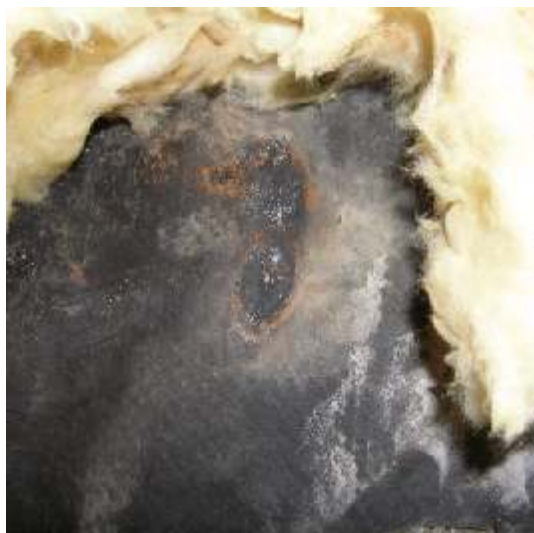
Actinomyceter på forhudningspapp i en utlekket kjellervegg
