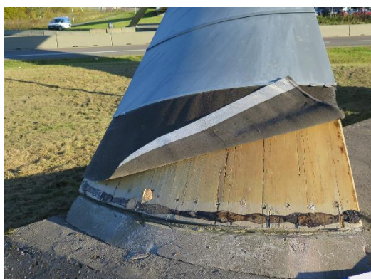
Foto 10. Nordbue, ved fundament mot vest. Ingen tegn til råtesoppkader. Noe oppsprekking og tegn til kjemisk nedbrytning i tilknytning til enkelte av borsyrepatronene.
