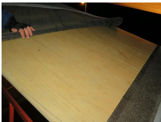
Foto 9. Nordbue, ca 13 m fra vestre fundament. Ingen synlige tegn til nedbrytning, svært begrenset oppsprekking. Ikke gjort råtedrilling.
