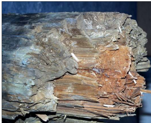
Kraftige gråråteskader i telefonstolpe.
