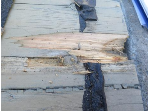
Foto 4. Sørbuens østre fot. Oppfliset område der det har vært en festeskruve for beslaget. Noe "mørning" rundt borsyrepatronen.
