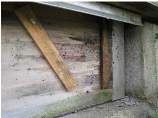
Foto 16. Brubane, enden mot øst, sørsida. Svært høy fuktighet i trevirket innerst mot endebeslaget. Kantbjelken er noe nedbrutt av grååte.
