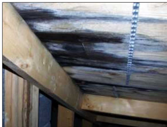
Misfarging av innvendig takbord forårsaket av fargeskadesopp.
