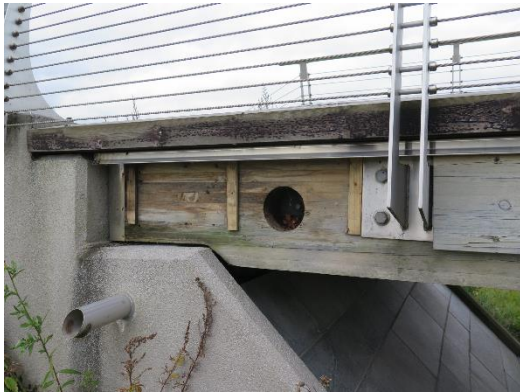
Foto 14. Kantbordet i enden ble demontert for kontroll. Tilgjengelig trevirke innenfor kantbordet var merkbart vått ved inspeksjonen, og bjelken nærmest kantbordet viste klare tegn til nedbrytning i enden.
