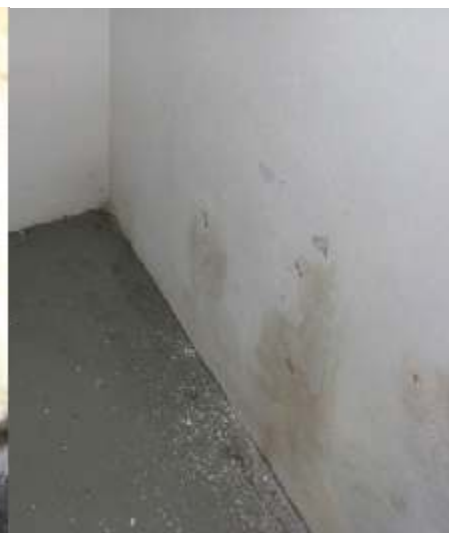
Actinomyceter vokser ofte på fuktbelastede betongoverflater.
