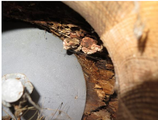
Foto 15. Strammestaget innenfor kantbjelken har komprimert råtesoppskadet trevirke. Bjelkene nærmest kanten er sterkt nedbrutt av rekkekjuka.
