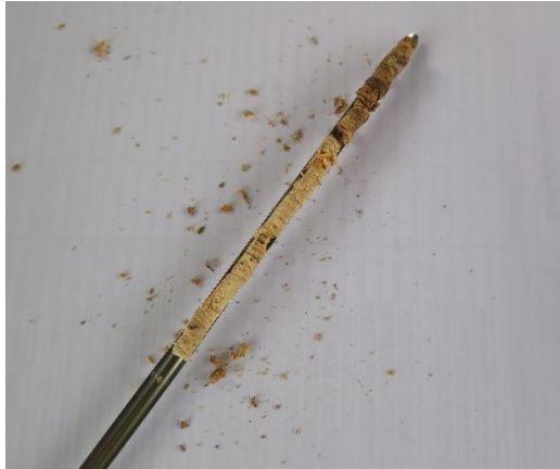
Foto 13. Borprøve tatt nær enden mot vest, i søndre del av brubanen (ved råtedrilling nr. 11). Prøven viser nedbrutt ved ca 7 cm inn i limtrebjelken.
