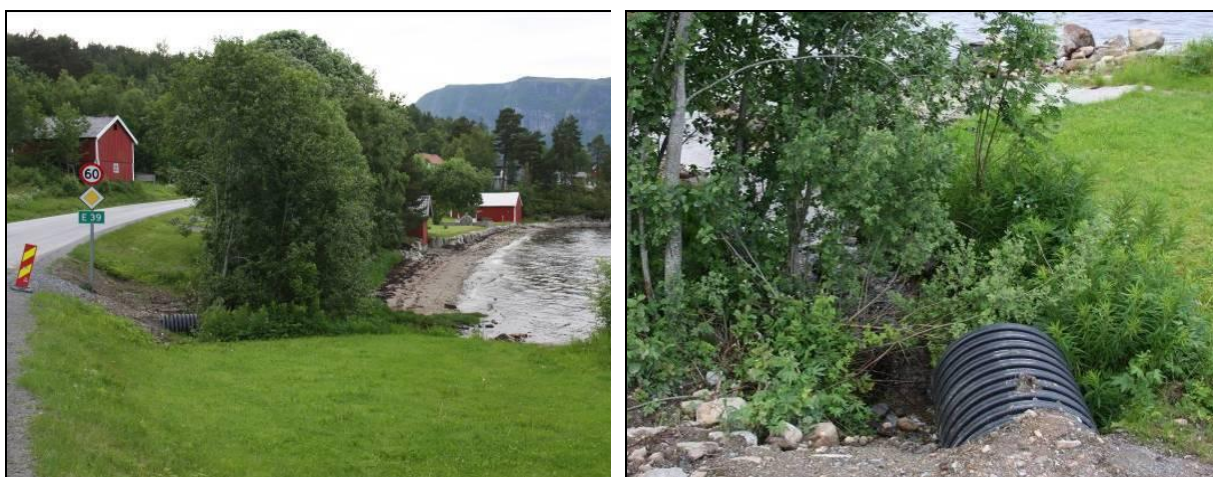
Figur 35. Torbugbekken like vest for fergekaia hadde den 13. juni 2011 nyleg blitt lagt i røyr under E39-vegbana. Denne løysinga hindrar oppgang av anadrom. Foto: Ole Kristian Spikkeland.
