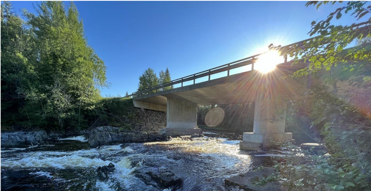
Figur 3-2. Foto som viser dagens bru sett mot nord-vest fra undersiden ved fossen.
