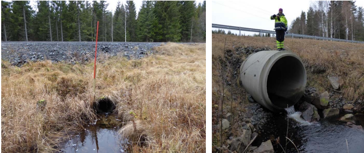
Figur 13 Foto t.v.; stikkrenne under rv. 3. Foto. t.h. Kulvert under rv. 3. Kulverten ligger høyt i terrenget.
