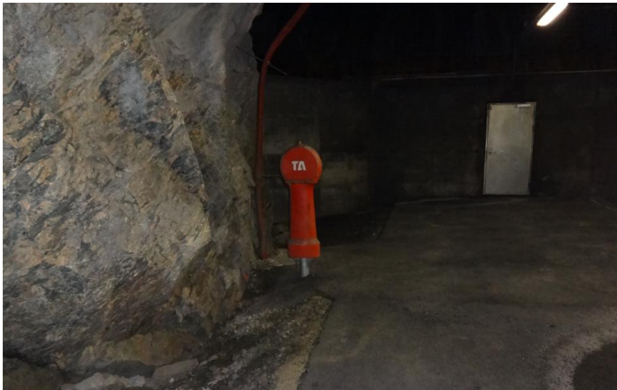
Figur 20: Branhydrant i tverrslag
