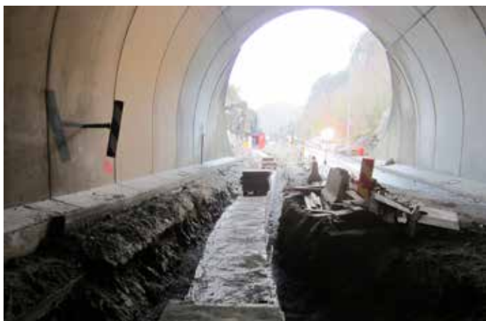
Det er nye kabelgrøfter på hele strekningen fra teknisk bygg i Sundslia til teknisk bygg ved Loga. Til sammen 75000 meter med kabel er lagt ut i 70000 meter trekkør. (Foto: John T. Hodne)
